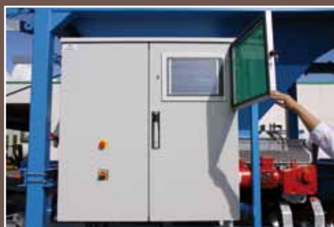
DER SCHALT- UND BEDIENSCHRANK ist direkt montiert und liefert mit Sensoren den zuverlässigen Arbeitsstand der Anlage.
