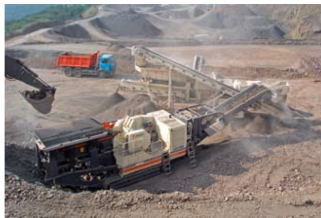
20 Mobile Aufbereitungsanlage im Basaltsteinbruch (Asamer Group) Mobile preparation plant in a basalt quarry (Asamer Group)
