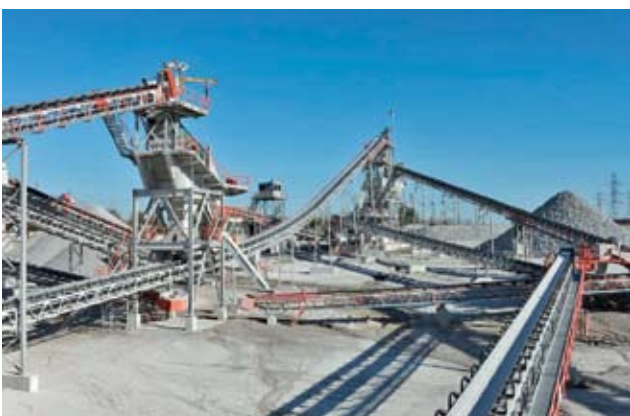
11 Aufbereitungsanlage Harding Street (HeidelbergCement) Harding Street preparation plant (HeidelbergCement)
