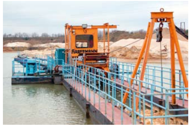
14 Saugbaggerbetrieb Kieswerk Goldbeck (H. Dallmann GmbH, Harder) Suction dredger operation at Goldbeck gravel works (H. Dallmann GmbH, Harder)
